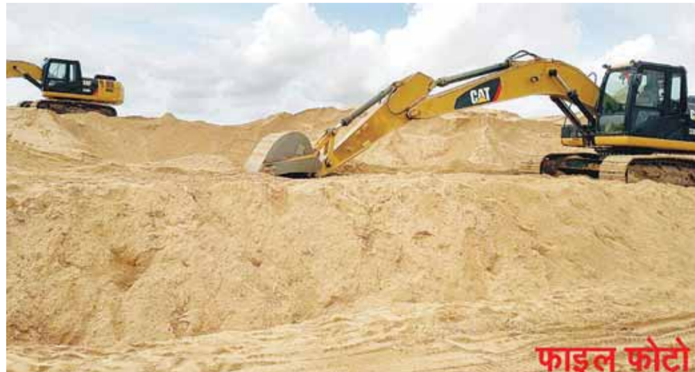
भण्डारण में रेत स्टॉक कर रखी है, ताबडतोड़ अवैध उत्खनन के कारण नदी का स्वरूप ही बिगाड़ रहा है। नदी की धार टूटने लगी है, घाट को भी क्षति पहुंचाची गई है। रेत माफिया के हाँसेले इतने बुलंद हैं कि उन दिन दहाड़े नदी में मशीन उतारकर खनन किया जा रहा है।
